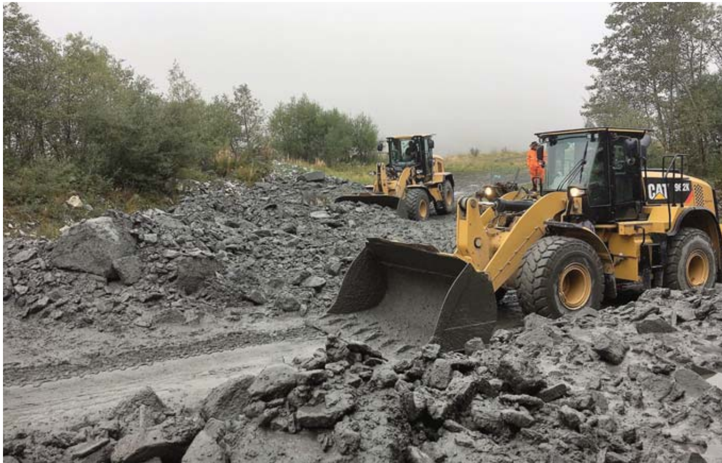
De gros moyens ont été engagés pour dégager la route qui a été partiellement rouverte au trafic en début de soirée. Mais les travaux de déblaiement et de remise en état se sont poursuivis durant toute la nuit. DR
